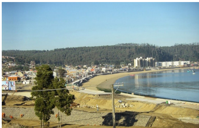
Figura 6. Trabajos de reconstrucción de la costanera de Dichato en el borde costero.
